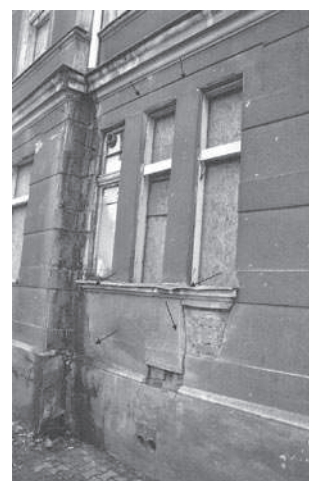
Rys. 7. Uszkodzenia ściany zewnętrznej północnej połączone z jej odchyleniem od pionu
