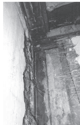
Rys. 12. Zbutwiałe elementy stropu i ściany w jednym z mieszkań na IV piętrze
