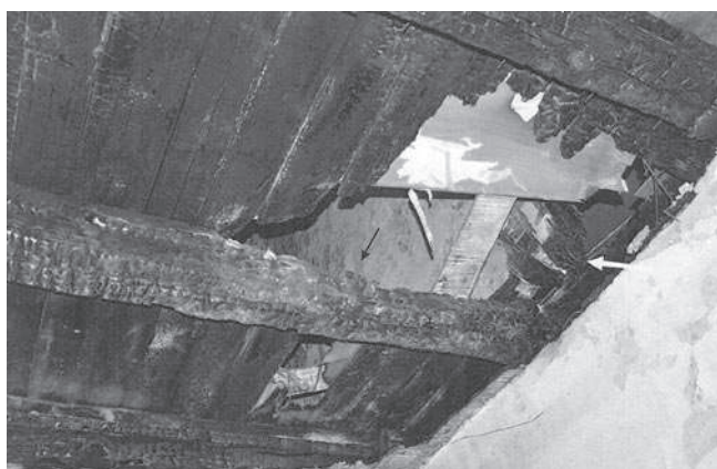
Rys. 4. Widoczne nadpalone elementy drewniane stropu i ściany nad parterem
