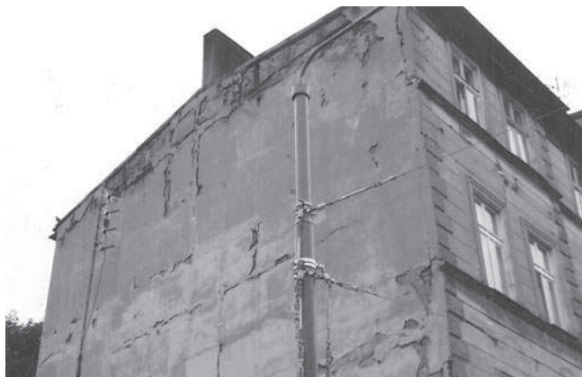
Rys. 9. Uszkodzenia tynków zewnętrznych na ścianach budynku połączone z deformacjami szkieletu drewnianego
