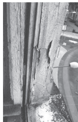
Rys. 13. Stan obróbek blacharskich gzymsu, parapetu, ościeża okiennego, okna w jednym z mieszkań od ulicy
