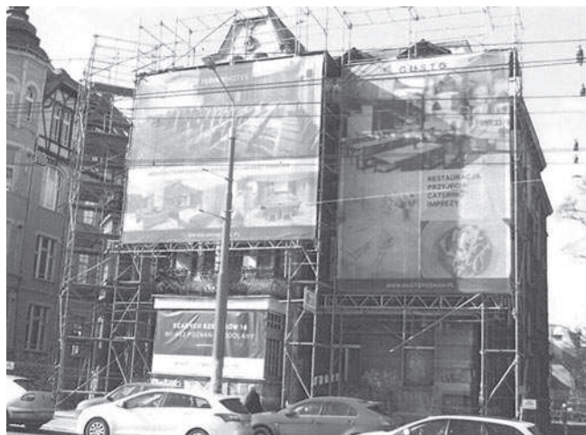
Rys. 8. Elewacja wschodnia (od ulicy) i sposób jej tymczasowego zabezpieczenia
