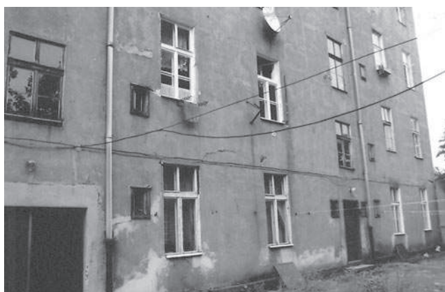
Rys. 10. Uszkodzenia tynków i konstrukcji ścian od strony podwórza
