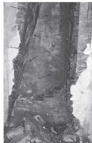
Rys. 6. Destrakcja szkieletu drewnianego i wypełniającego go muru w ścianie zewnętrznej. Tynk zewnętrzny trzyma się na siatce stalowej
