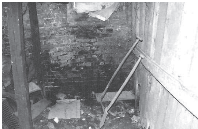
Rys. 11. Zawilgocona ściana piwnic, zarwany strop drewniany nad piwnicą podparty słupem drewnianym, który zbutwiał
