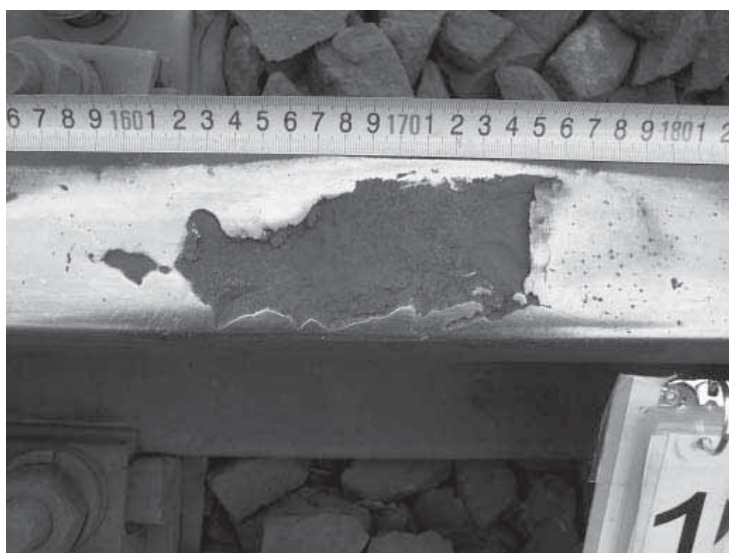
Fot. 2. Wada 227 squat o głębokości 4,6 mm w km 461,990 w lewym toku szynowym
