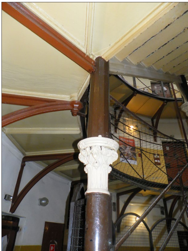
Ryc. 8. Kapitel żeliwnej kolumny stanowiącej podparcie schodów – dekoracja; po lewej fragment galerii opartej na wspornikach żeliwnych; fot. Ł. Lewandowski 2015.
