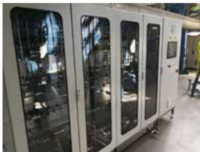
Rys. 3. Moduł mieszający wraz z szafą elektryczno-AKPIA
