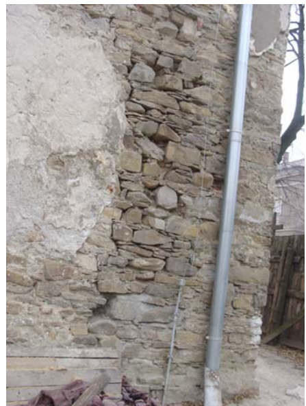
Ryc. 6. Cerkiew w Baligrodzie – wypłukany mur – listopad 2011 r. (fot. J. Kufel) Fig. 6 The Orthodox Church in Baligród – washed out masonry – November 2011 (photo J. Kufel)
