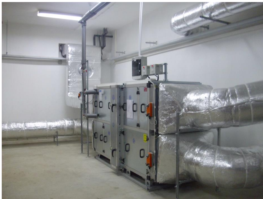
Rys. 4. Centrala wentylacyjna nawiewno-wywiewna z obrotowym wymiennikiem ciepła współpracująca z płaszczyznowym i rurowym gruntowym wymiennikiem ciepła z pełni automatycznym sterowaniem (fotografia – zbiory własne)
