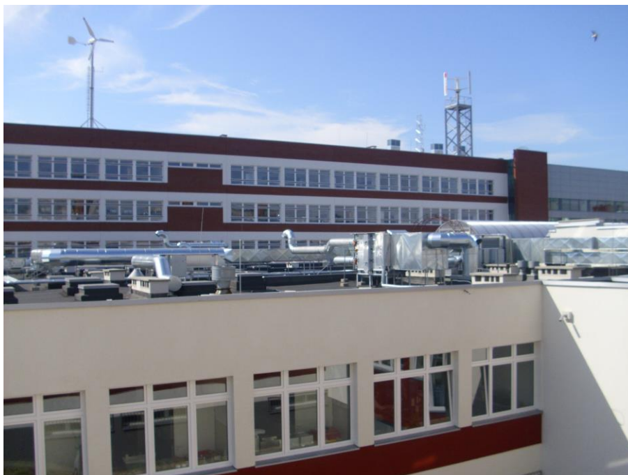
Rys. 2. Centrale nawiewno-wyiewne umieszczone na dachu wentylowanego budynku (fotografia – zbiory własne)
