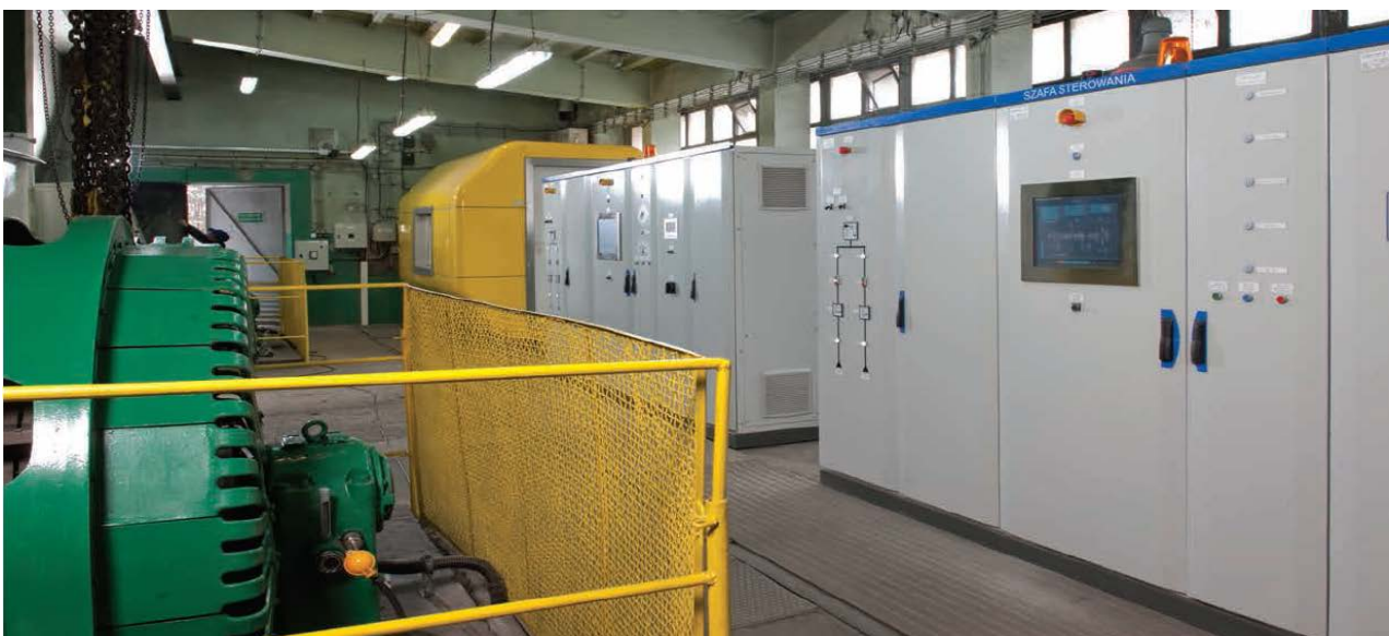
Rys. 4. Realizacja zintegrowanego systemu sterowania stacji wentylatorów [mat. firmy JJA Progress]
