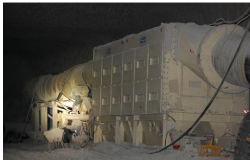
Rys. 2 Widok odpylacza suchego HTKK w komorze solnej ZG „Polkowice-Sieroszowice”
