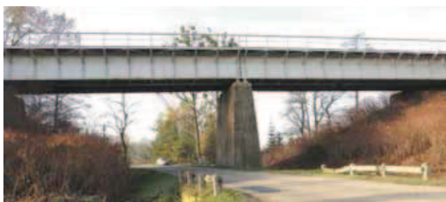
Rys. 1. Widok od strony wschodniej na most [6] Fig. 1. View of the east side of the bridge [6]
