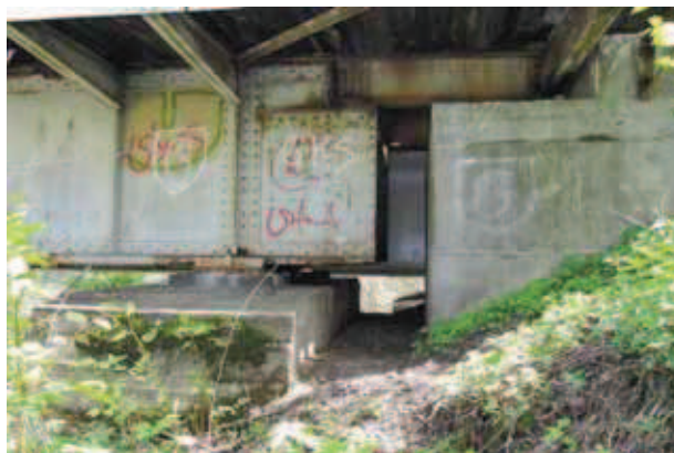
Rys. 2. Widok na przyczółek i przęsło skrajne [6] Fig. 2. View of the abutment and span [6]
