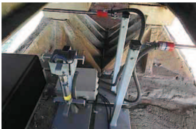
Rys. 4. Konstrukcje wsporcze do mocowania czujników kąta i czujników przemieszczeń na podporze środkowej [6] Fig. 4. Support structures for mounting angle sensors and displacement sensors at intermediate support [6]
