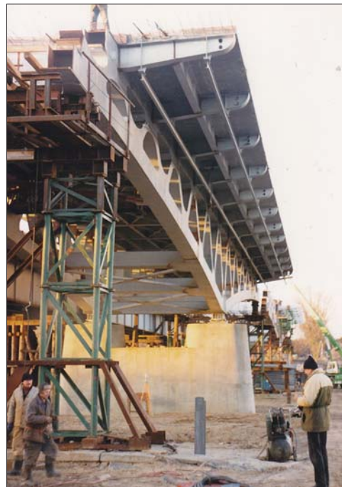
Fot. 5. Podparcie wsporników dźwigarów kratowych do czasu sprężenia płyty pomostu i połączenia środkowych, blachownicowych części przęseł
