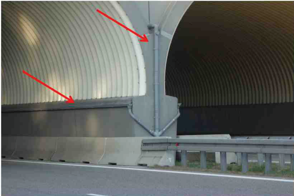
Rys. 6. Przykład wykonania elementów odwadniających strefę przypodporową mostu ekologicznego w postaci rur spustowych i rynien obiektu zainstalowanych dodatkowo już po realizacji obiektu (fot. A. Wysokowski)
