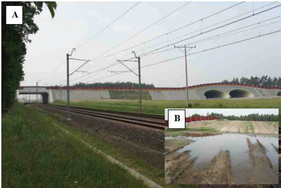
Rys. 5. Problem i skala właściwego odwodnienia powierzchniowego dla mostu ekologicznego nad magistralną linią kolejową i jednocześnie nad drogą szybkiego ruchu {15} (fot. A. Wysokowski): a) widok ogólny konstrukcji mostu ekologicznego, b) widok stanu nawierzchni przejścia
