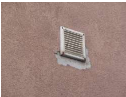
Fot. 13 Uszkodzenia mechaniczne powstałe w wyniku naprężeń między dwoma materiałami oraz dodatkowo na skutek zawilgocenia.
