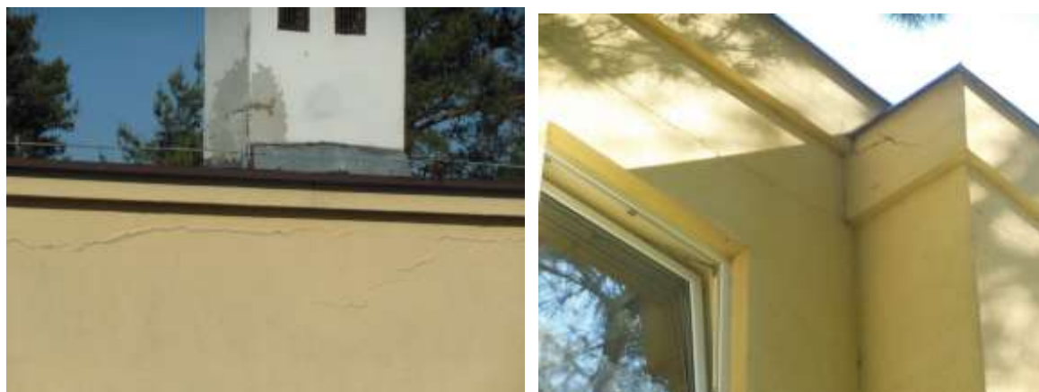
Fot. 6 Uszkodzenia mechaniczne powstałe w wyniku naprężeń pomiędzy poszczególnymi elementami konstrukcji budynku.
