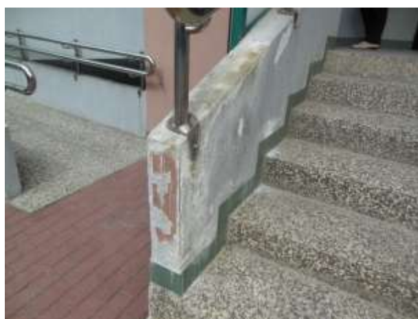
Fot. 8 Uszkodzenia mechaniczne, przemarzanie tynk bezpośrednio na ścianie murka balustrady schodów.
