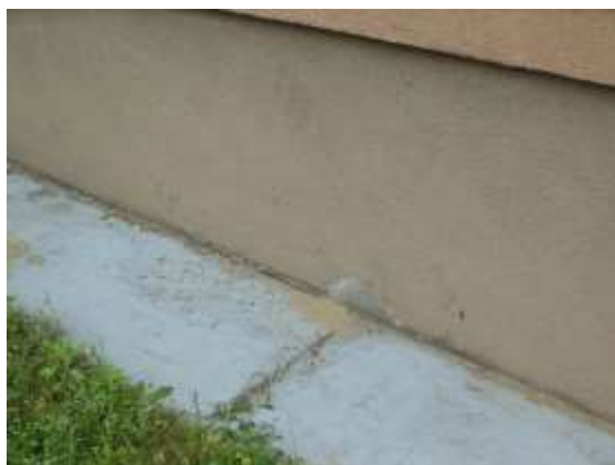
Fot. 10 Uszkodzenia mechaniczne tynków mozaikowych w dolnej części ściany.
