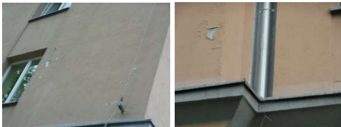
Fot. 11 Odparzenia tynków na skutek nieodpowiedniego zagruntowania podłoża.
