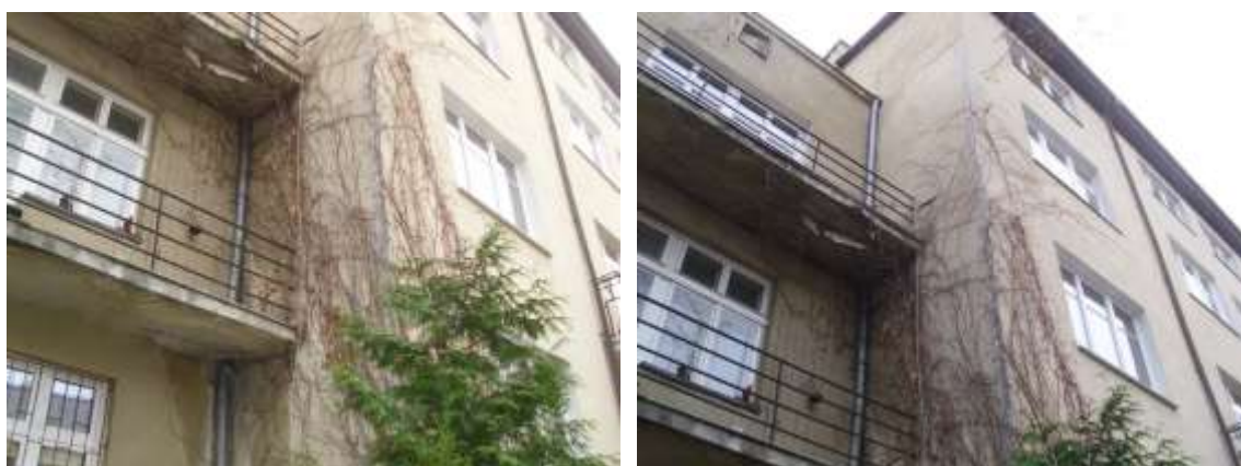
Fot. 14 Uszkodzenia tynków w wyniku porastającej na nich roślinności.
