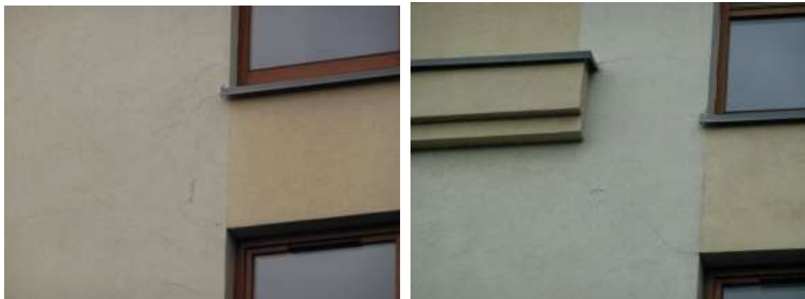
Fot. 4 Uszkodzenia w postaci pęknięć w okolicy narożników okiennych.
