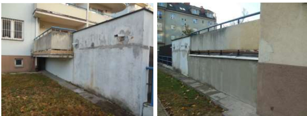
Fot. 2 Uszkodzenia powstałe na skutek zawilgoceń i przemarzania.
