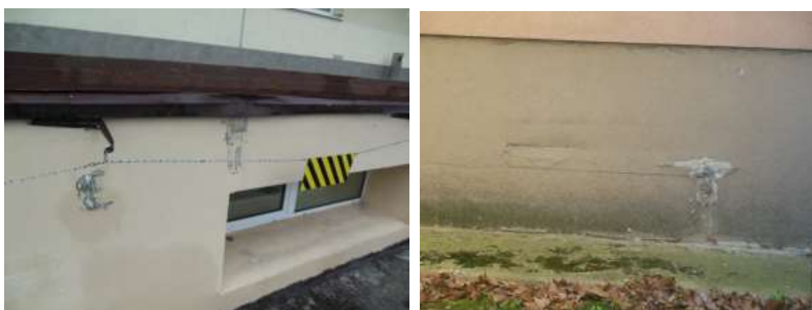
Fot. 5 Uszkodzenia mechaniczne powstałe w wyniku uderzenia.
