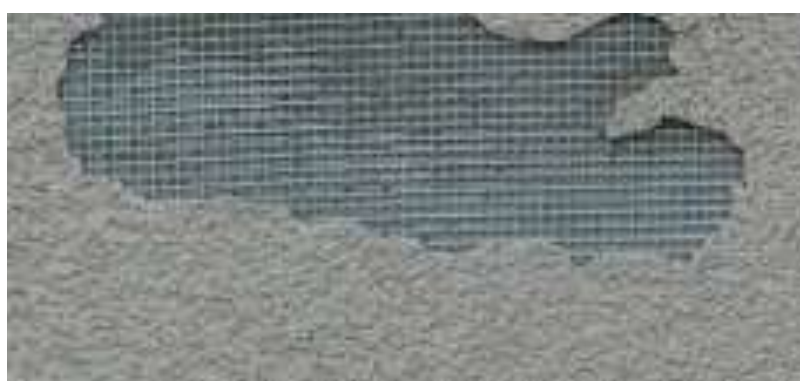
Fot. nr 17 Uszkodzenie mechaniczne tynku zbrojonego dwuwartwowo siatką z włókna szklanego w okolicy bois szkolnych.
