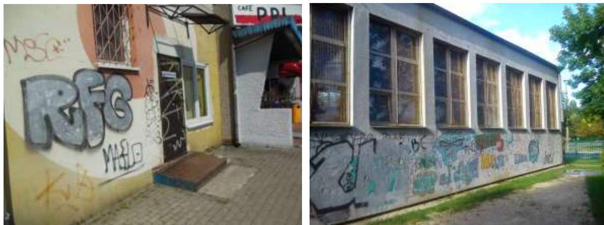
Fot. 16 Uszkodzenia tynków elewacyjnych w wyniku aktów wandalizmu (graffiti).
