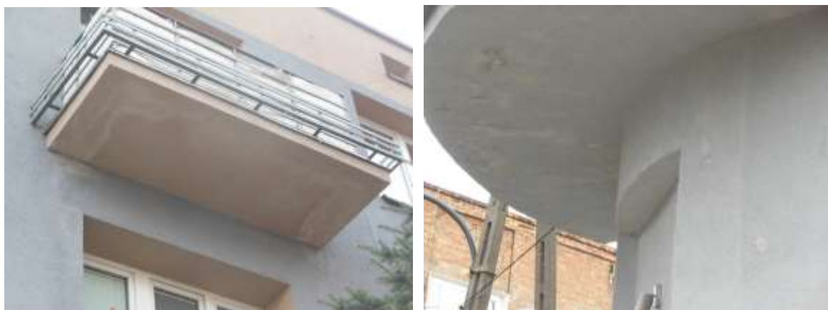
Fot. 12 Uszkodzenia tynków na skutek zawilgocenia (nieszczelności obróbek i izolacji płyt balkonowych)
