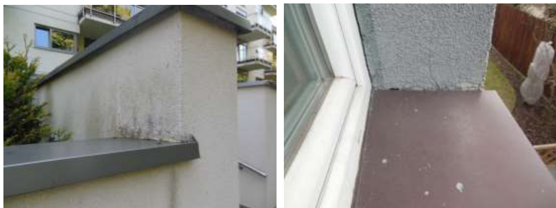
Fot. 15 Brak stosownego wykończenia obróbek i parapetów przyczyniający się do powstawania uszkodzeń tynków.
