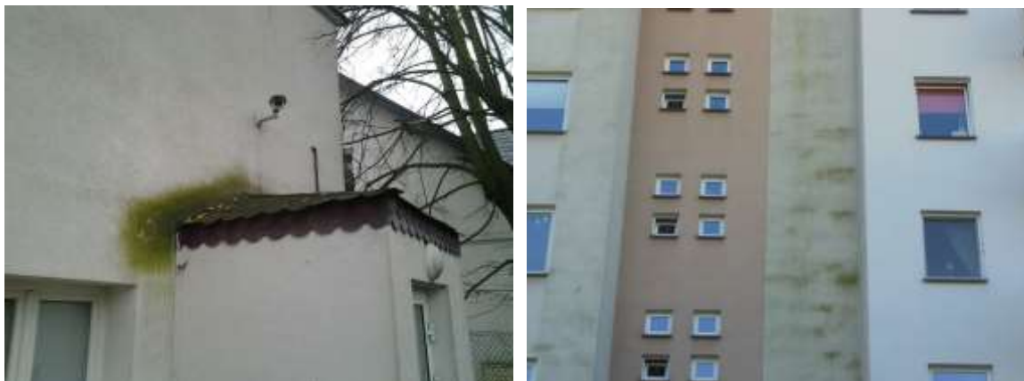
Fot. 1 Uszkodzenia biologiczne (elewacje przy drzewach oraz od północy).
