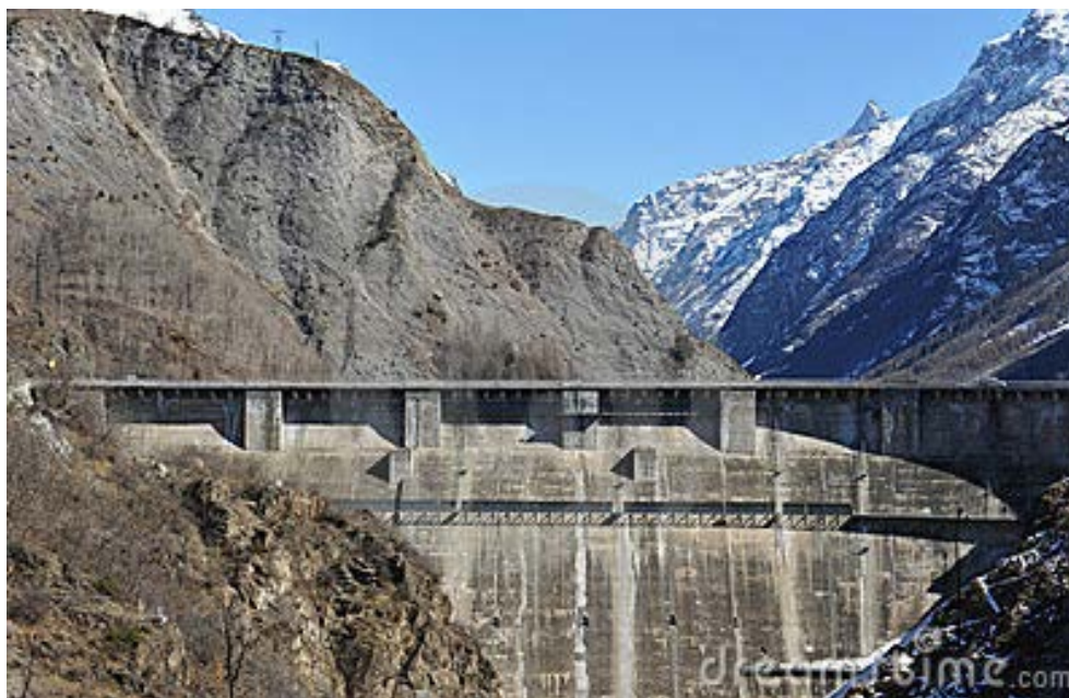
Rys. 2. Tama Chambon na rzece Romanche we Francji; pęknięcia w betonie wywołane zjawiskiem reakcji alkalia-krzemionka (www.dreamstine.com)
