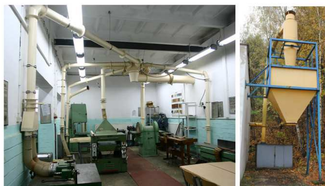
Rys. 1. Widok badanej pneumatycznej instalacji odciągowej
