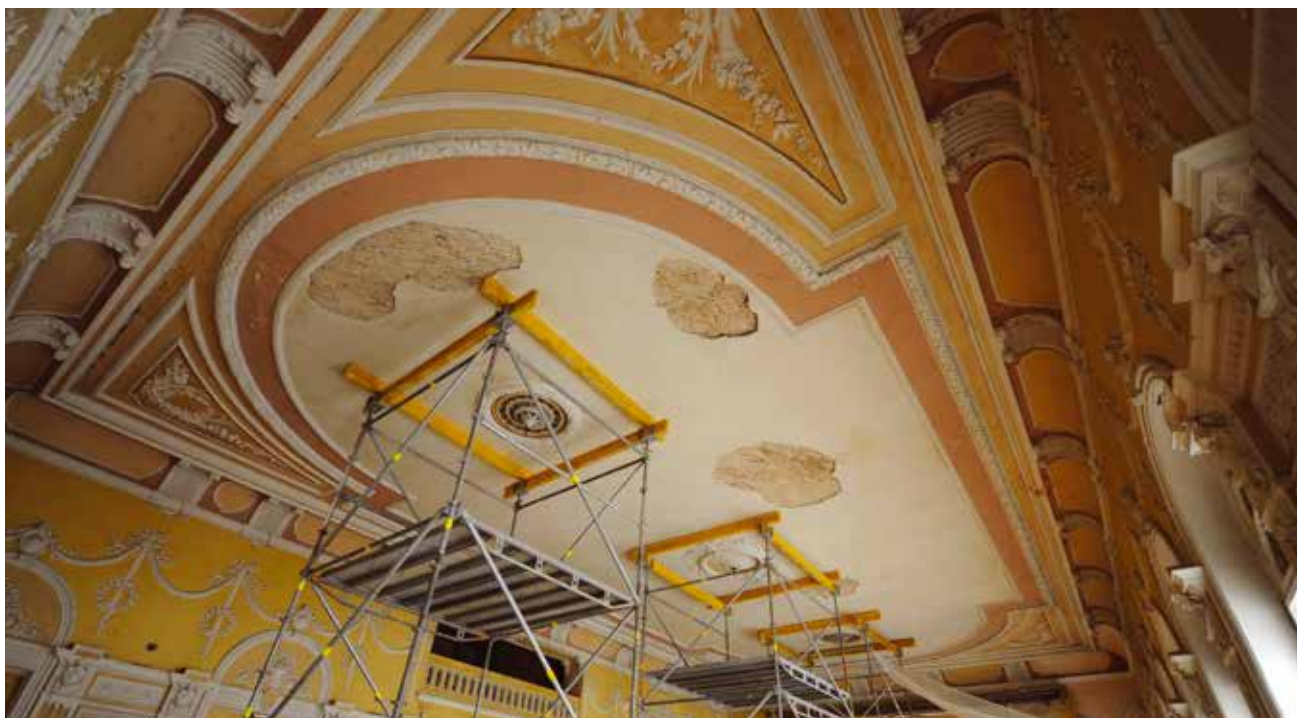
Fot. 1. Sufit w sali teatralno-kinowej – stan przed rozpoczęciem prac rewitalizacyjnych; źródło: [5]
