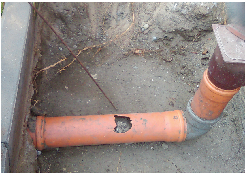
Fot. 3. Uszkodzone mechanicznie przyłącza kanalizacji deszczowej w miejscu wprowadzenia rury spustowej usytuowanej pomiędzy częściami B i C budynku sali BHP
