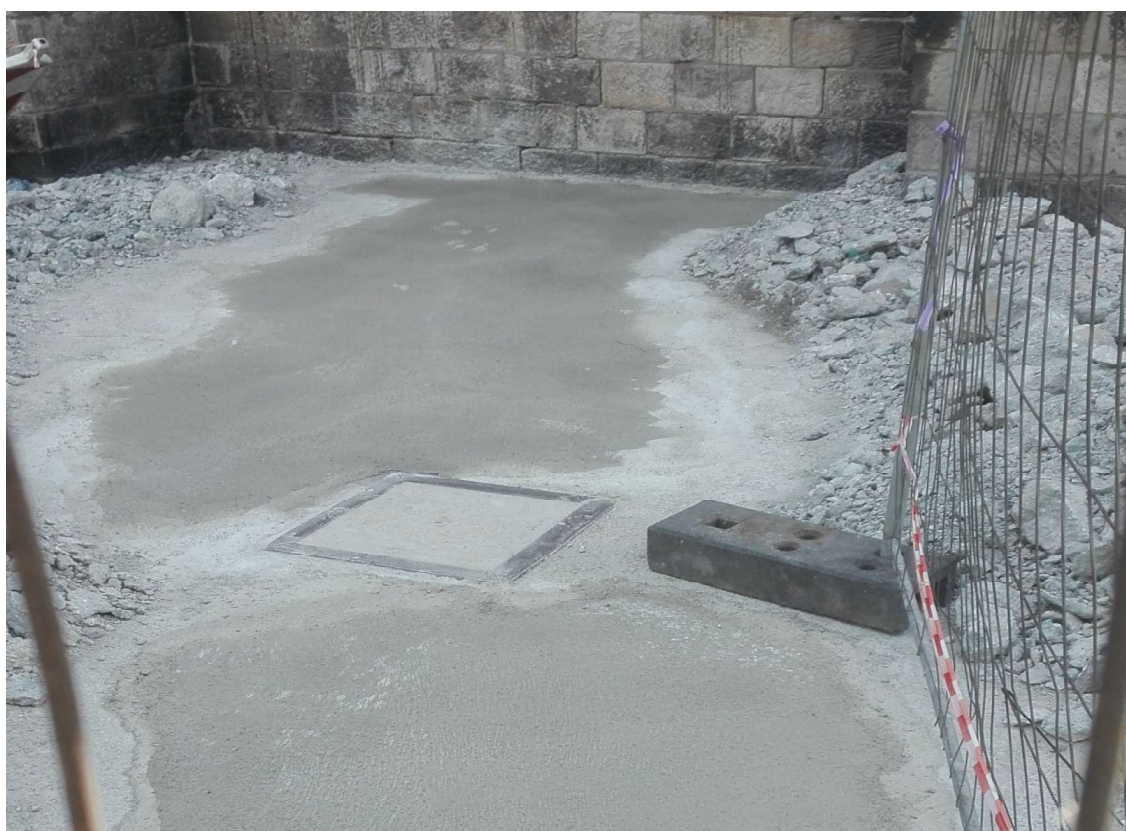
Rys. 12. Wykonany remont pękniętej płyty żelbetowej okalającej kościół Fig. 12. Renovation of the cracked reinforced concrete slab surrounding the church
