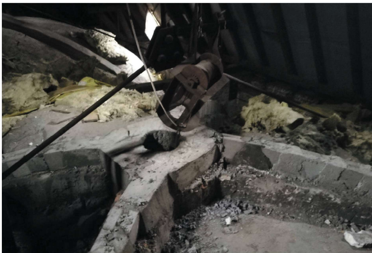
Rys. 19. Widok zabezpieczenia sklepienia kościoła przez wzmocnienie żebier sklepienia według pomysłu T. Niemca Fig. 19. The view of the protection of the church's vault by strengthening the vault ribs according to the idea of T. Niemiec
