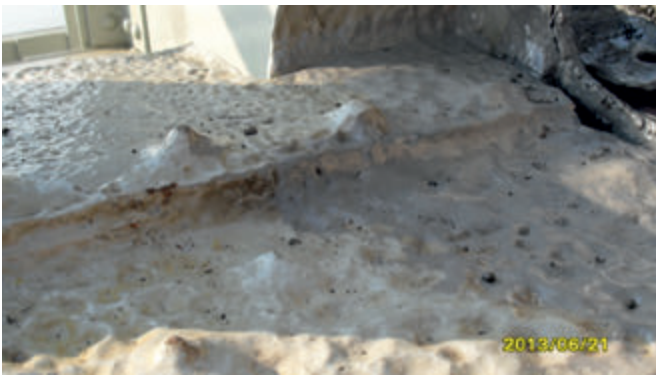
Rys. 4. Przykładowe zamalowane niezgodności (istotne ubytki korozyjne na powierzchni elementu) ujawnione w trakcie badań wizualnych
