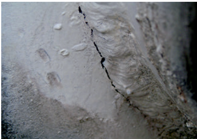
Rys. 5. Defektogram proszkowy pęknięcia eksploatacyjnego
