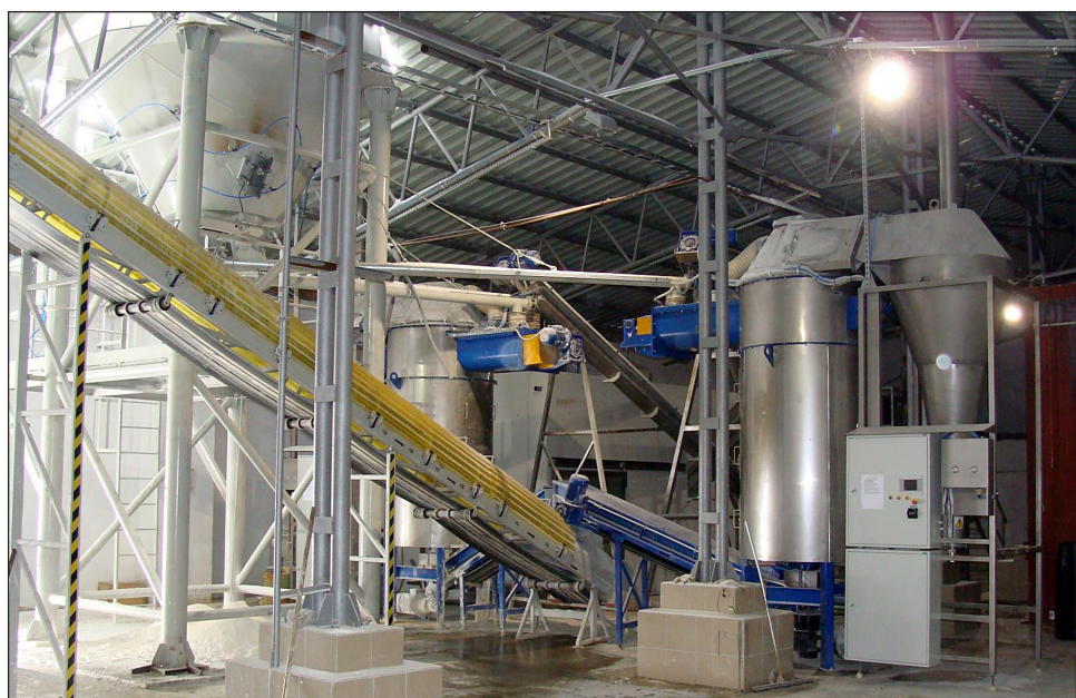
Rys. 3. Instalacja technologii FuelCal do wytwarzania nawozów OrCal®
