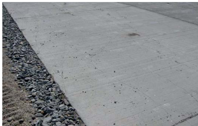
Fot. 17. Rubblizing zmodyfikowany w odmianie CSO (Crack & Seat & Overlay) – na powierzchni płyty betonowej widoczne są spękania włoskowate
