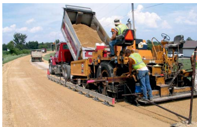
Fot. 18. Pośrednia warstwa podbudowy z kruszywa łamanego układana na płycie betonowej poddanej zabiegowi typu rubblizing zmodyfikowany
