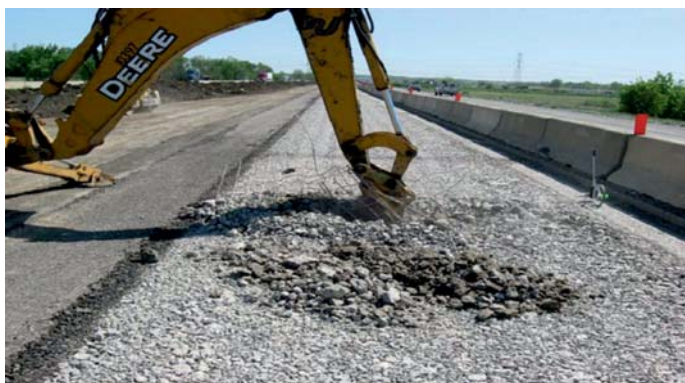
Fot. 10. Wykonywanie odkrywek testowych w pokruszonej udarowo betonowej dylatowanej nawierzchni zbrojonej (JRCP)
