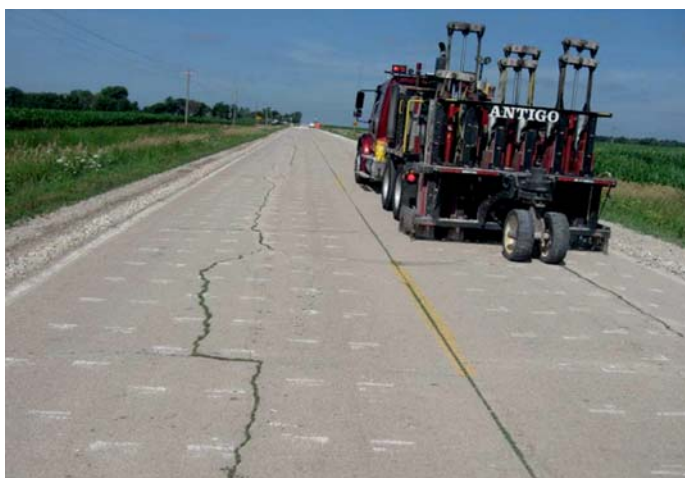
Fot. 16. Rubblizing zmodyfikowany w odmianie CSO (Crack & Seat & Overlay) wykonywany za pomocą urządzenia wielomotowego MHB
