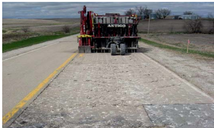
Fot. 11. Typowy rubblizing zmodyfikowany – nawierzchnia płytowej wykazuje znaczny stopień odtupiania mniejszych kawałków od struktury betonu
