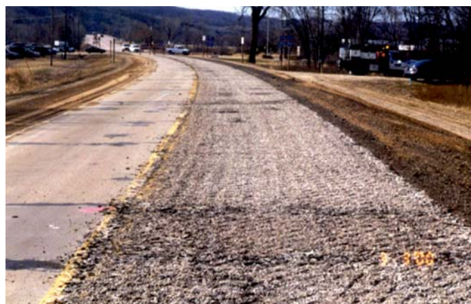
Fot. 7. Wyrównanie powierzchniowe uszkodzeń i dylatacji nawierzchni betonowej (pokruszenie i zawałowanie) celem jej odprężenia i ochrony przed spękaniem odbitymi
