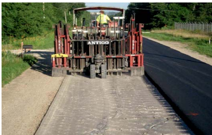
Fot. 14. Typowy rubblizing zmodyfikowany – nawierzchnia płyty betonowej wykazuje zróżnicowany stopień odlupania mniejszych kawałków od struktury betonu
