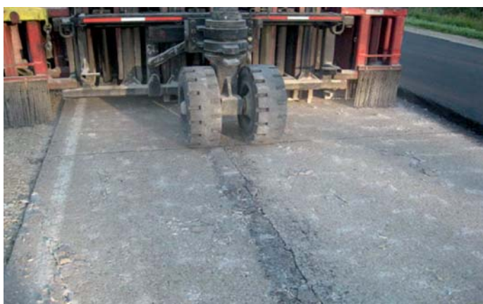
Fot. 15. Typowy rubblizing zmodyfikowany – łatwo dostrzegalne spękania na nawierzchni płyty betonowej
