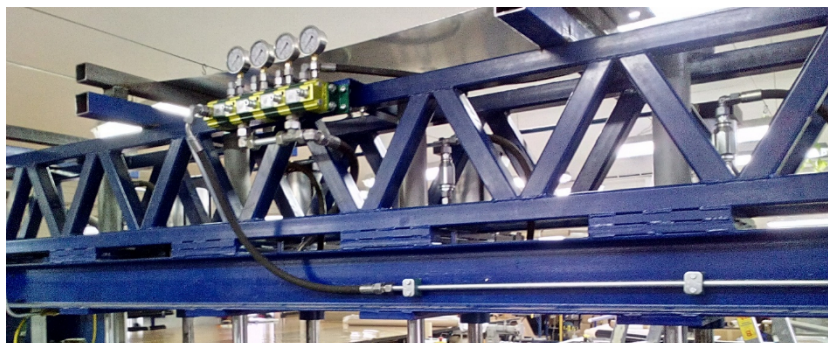
Rys. 9. Widok rozdzielacza wyrównującego ciśnienie na siłownikach
