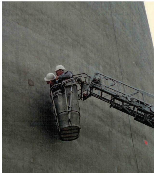
Rys. 10. Monitoring zmian uszkodzeń konstrukcji częściowo sprężonego silosu na klinkier
