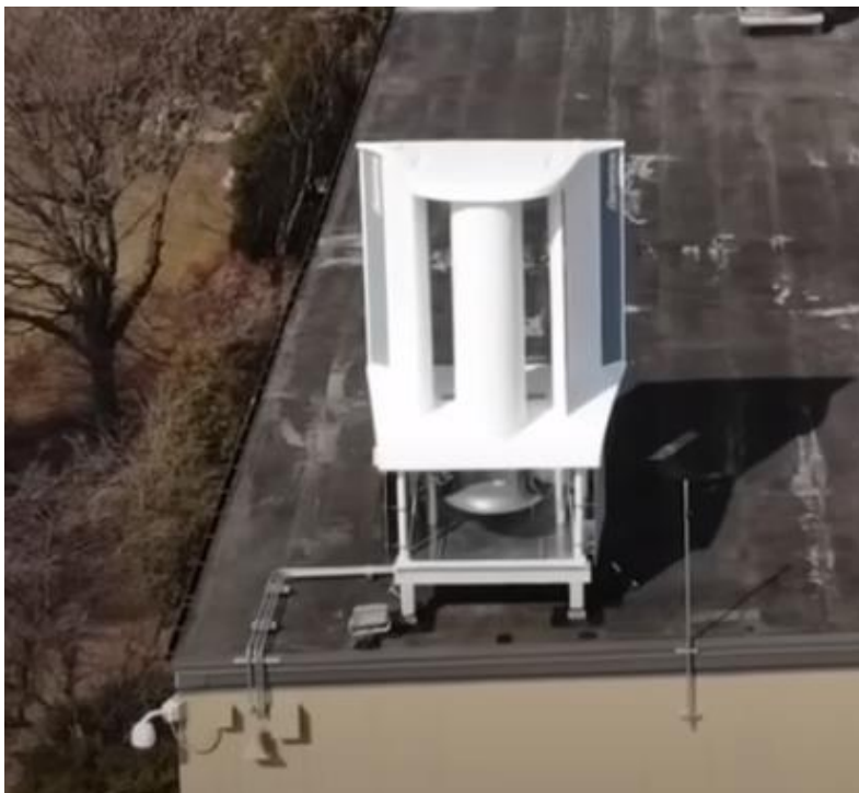
Rys. 30. Nieruchoma turbina wiatrowa Źródło: opracowanie własne
