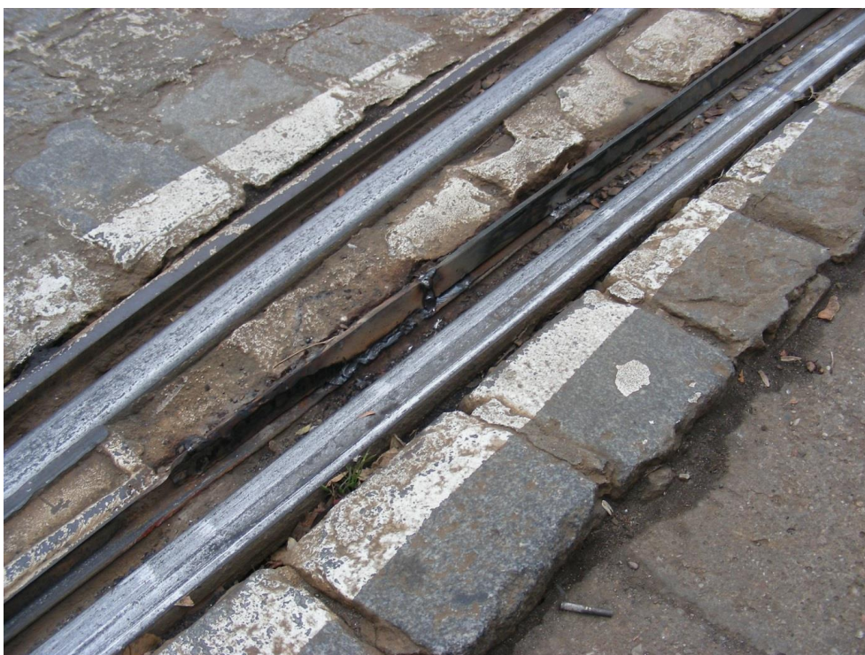
Rys. 3. Całkowicie zużyta warga rowka wewnętrznego toku szynowego w łuku, prowizorycznie zastąpiona płaskownikiem
