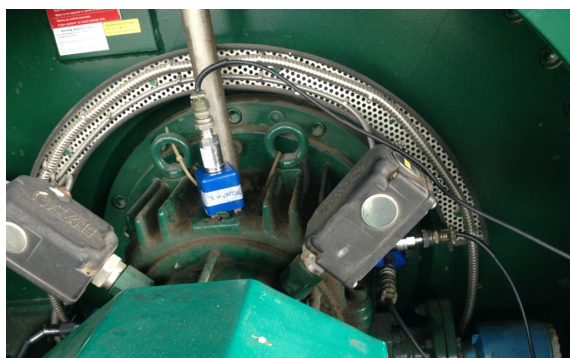
Rys. 6. Widok czujników XY w węźle łożyskowym silnika
