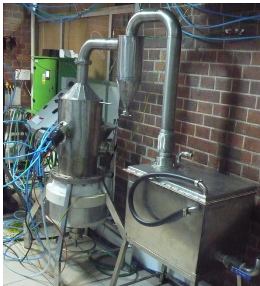
Rys. 3.4. Widok zasadniczych elementów instalacji do plazmowego zgazowania
