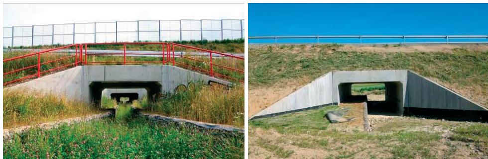
Rys. 1. Rozwiązanie przejścia dla małych zwierząt w formie półek z gabionów w obiekcie PZM 33
