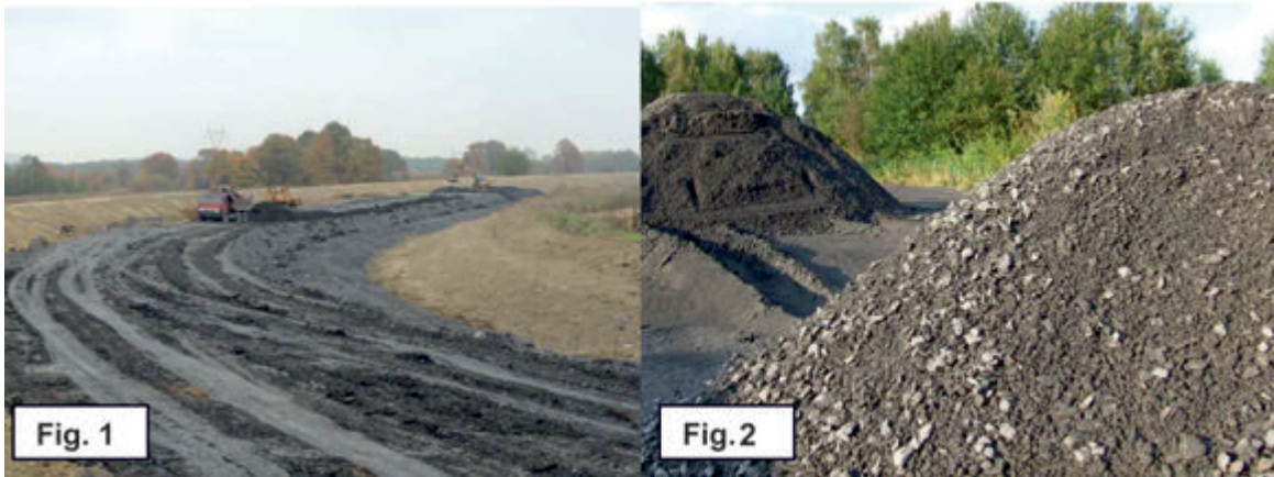
Rys. 1. Budowa wału przeciwpowodziowego na rzece Wiśle w miejscowościach Gromiec-Mętków z wykorzystaniem kruszyw produkowanych w ZG Janina (materiały TAURON Wydobycie S.A., fot. K. Paw)
