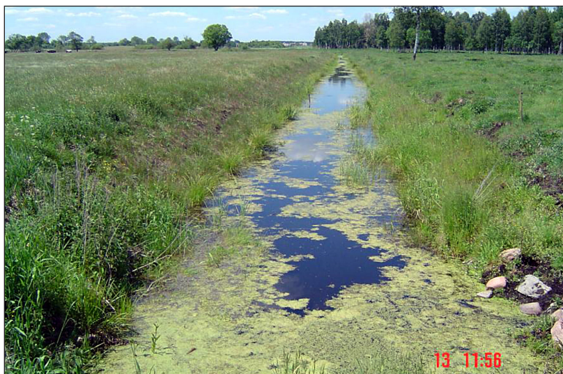
Fot. 2. Zarośnięty i niekonserwowany rów melioracyjny. Fot. A. Kiryluk Phot. 2. The overgrown and non-conservation of drainage ditch. Phot. A. Kiryluk
