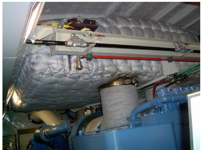
Rys.6 Widok zabudowanej dyszy rozpylającej instalacji gaśniczej firmy Fogtec
