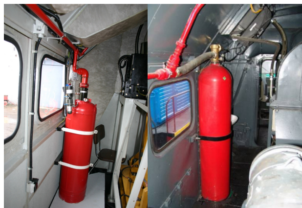
Rys.2 Zabudowa stałej instalacji gaśniczej na gaz FM-200 a – w lokomotywach ST44BF i ST44PC b – w lokomotywach ST44 dla LHS, PKP i Pol Miedz Trans
