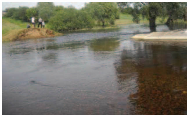
Rys. 8. Górny przelew wałowy polderu Golina w miejscowości Kraśnica z widoczną wyrwą na prawym przyczółku przelewu (fot. I. Laks – 6 czerwca 2010 roku)
