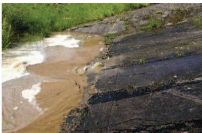
Rys. 7. Wymywanie piasku z korpusu budowli (sufozja) na prawym przyczółku górnego przelewu wałowego polderu Golina (fot. Z. Sroka – 22 maja 2010 roku)
