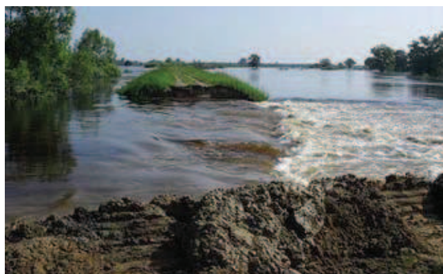
Rys. 9. Przekop w wale wykonany w celu przyspieszenia opróżniania się polderu Golina po przejściu kulminacji fali powodziowej (fotografia wykonana 29 maja 2010 przez pracowników WZMIUZ oddział Konin)
