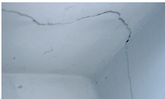
Fot. 2. Stan techniczny konstrukcji klatki schodowej. Widoczne pęknięcia ścian i spoczników klatki schodowej
