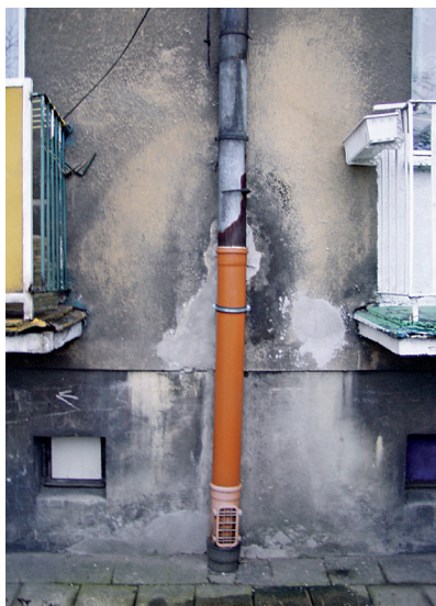
Fot. 5. Zawilgocenie ścian w rejonie rury spustowej między klatkami 44 i 46
