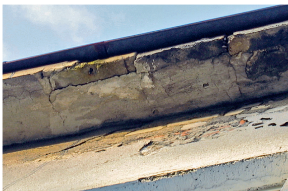
Fot. 6. Stan techniczny gzymsów dachowych
