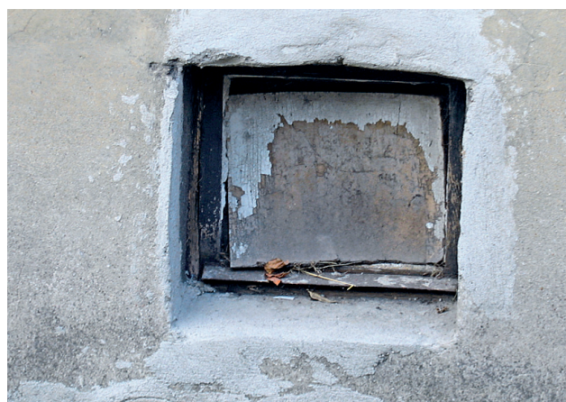
Fot. 9. Stan techniczny stolarki okiennej – brak oszklenia w otworach piwnic
