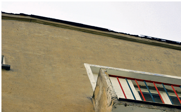
Fot. 7. Stan techniczny obróbek blacharskich
