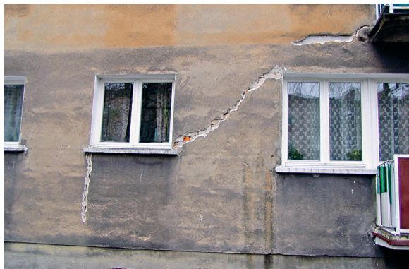
Fot. 1. Stan techniczny ścian zewnętrznych – zarysowania w narożniku klatki 46
