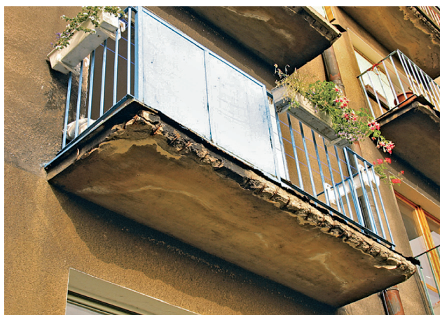
Fot. 8. Stan techniczny płyt balkonowych
