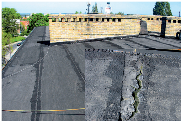
Fot. 4. Stan techniczny pokrycia dachowego. Widoczne znaczne uszkodzenia pokrycia papowego
