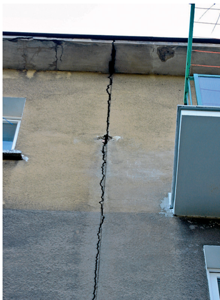
Fot. 10. Stan techniczny elewacji – dylatacja między klatkami 42–44
