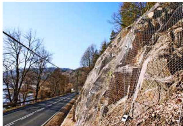
Kurtyna kotwiona zabezpieczająca pionowe zbocze skalne
