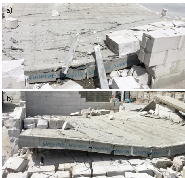
Rys. 10. Widok stropu po zniszczeniu
