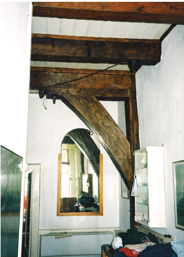
Fig. 4. Leiden, House Langebrug 55 from 1400 ± 6 (d) – timber-frame brace detail (photo by E.D. Orsel, ELO)
