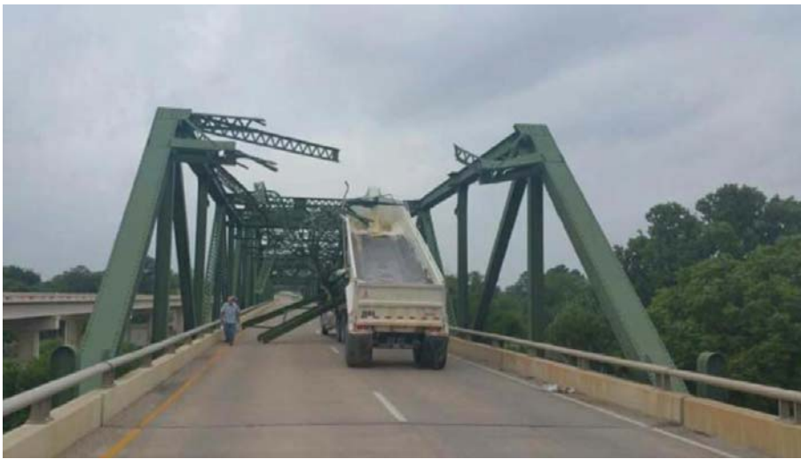
Fot. 8. Przykład uszkodzenia, przez pojazd z otwartą skrzynią ładunkową, ramy portalowej i górnych stężeń wiatrowych przęsła mostu na Westbound U.S. 67 na rzece Brazos w Somervell County [21]
