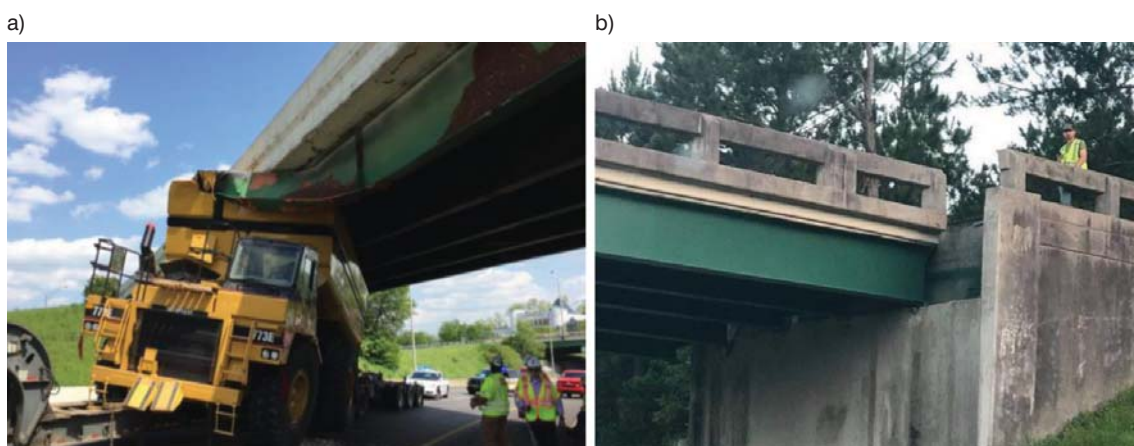
Fot. 5. Uderzenie ciągnika z naczepą w przęsło wiaduktu zespolonego: a) widok zaklinowanego pojazdu pod przęsłem oraz zniszczenie skrajnego dźwigara w Nashville w Tennessee, USA [18]; b) zrzucenie z łożysk (przesunięcie całego ustroju nośnego) na przyczółku wiaduktu autostradowego w Georgii, USA [24]
