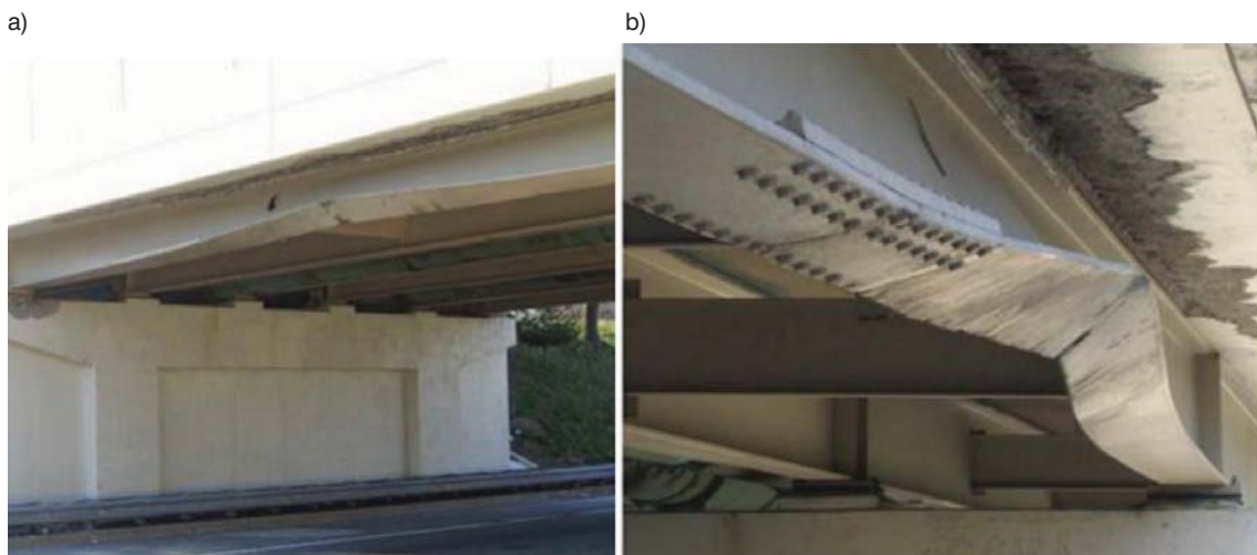
Fot. 4. Uszkodzenie przęsła wiaduktu zespolonego spowodowane uderzeniem ponadgabarytowego pojazdu na drodze międzystanowej nr 95 w stanie Delaware: a) widok ogólny przęsła; b) silna deformacja skrajnego dźwigara blachownicowego [17]
