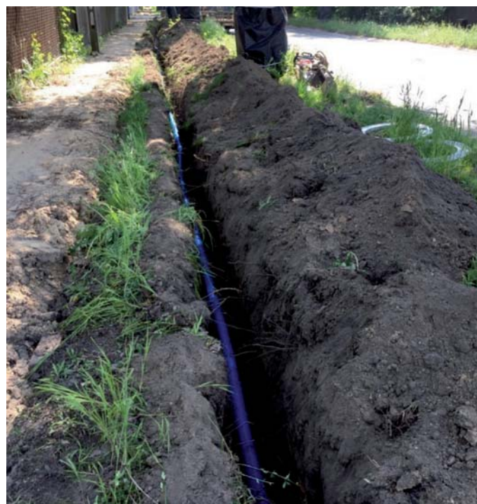
Fot. 5. Ułożenie instalacji w rejonie ul. Pszczelińskiej otwartym wykopem, zamiast technologią bezwykopową, spowodowało niepotrzebne, znaczne uszkodzenie systemu korzeniowego drzew. Sytuacji tej można było łatwo uniknąć. Na zdjęciu widoczne są również niewystarczające środki ochrony systemów korzeniowych drzew – zastosowano zupełnie nieskuteczną a wręcz szkodliwą ochronę w postaci obwiniecia drzew folią.
