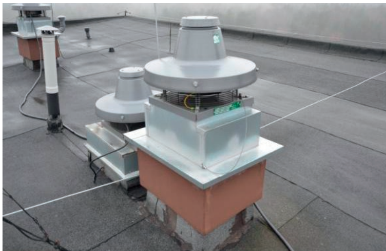
Fot. 2. Widok mechanizmu wentylacji mechanicznej od strony dachu
