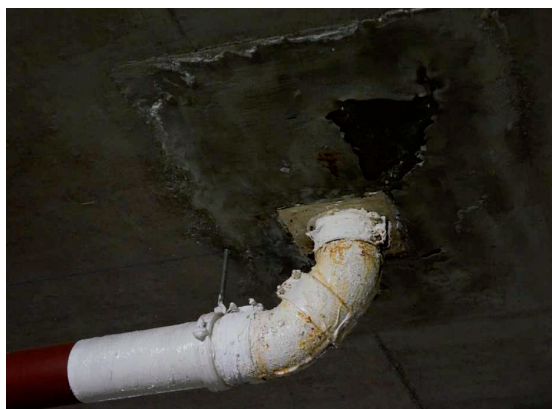
RYSUNEK 6. Wykwity przy przejściu rury przez strop pośredni w garażu wielopoziomowym FIGURE 6. Efflorescence at the transition of the pipe through the ceiling indirectly in the multi-storey garage
