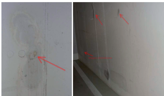
RYSUNEK 1. Zawilgocenia na ścianach zewnętrznych garażu FIGURE 1. Moisture penetration on the outside wall of the garage
