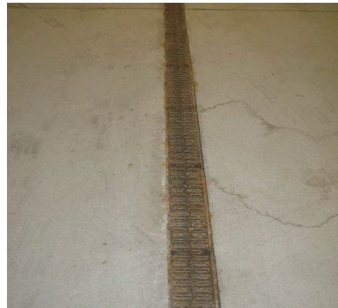
RYSunEK 5. Widoczne ślady korozji wskutek zalegania wody w korycie
