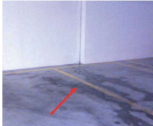
RYSUNEK 2. Przeciek z dylatacji konstrukcyjnej FIGURE 2. The leak of structural dilatation
