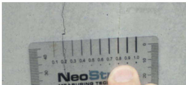
RYSUNEK 8. Pomiar szerokości rysy FIGURE 8. Measuring the width of cracks
