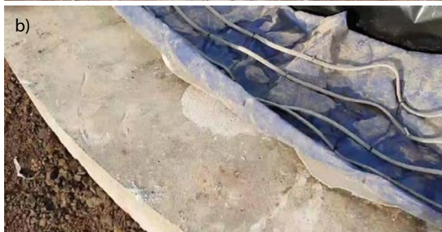
Rys. 9. Pielęgnacja wykonanej podlewki: a) ocieplenie matami, b) lokalizacja dodatkowych przewodów grzejnych (fot. autora)
