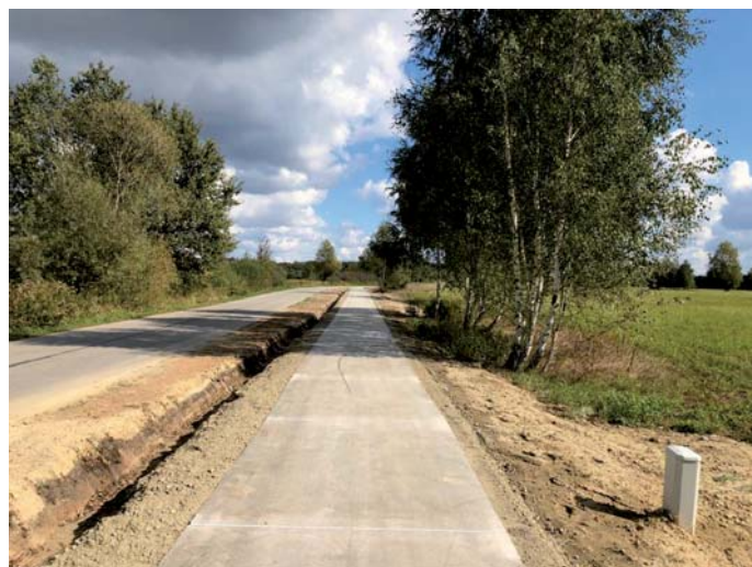
Fot. 4a. Przykład realizacji ścieżki rowerowej – odcinek drogi przed oddaniem do ruchu pojazdów
