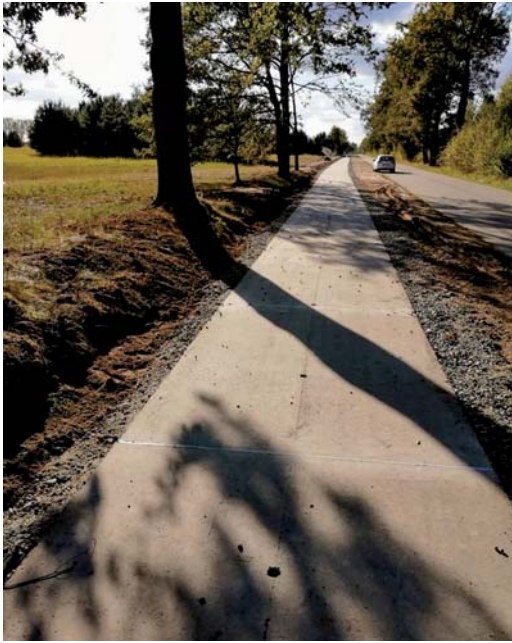
Fot. 4b. Przykład zrealizowanej ścieżki rowerowej – odcinek drogi przed oddaniem do ruchu pojazdów
