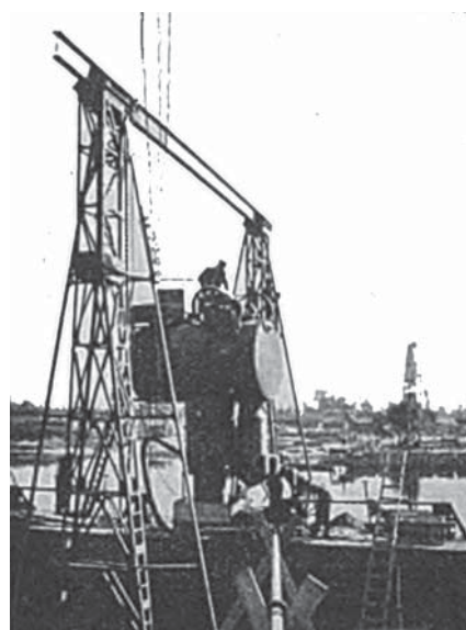
Fot. 1. Szkielet kesonu do wykonania fundamentów filarów nurtowych; prace przy budowie filara III [1]
