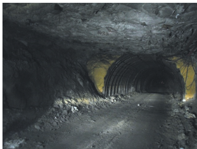
Rys. 4. Wyrobisko w obudowie podatnej z wykładką EKOFLEX
