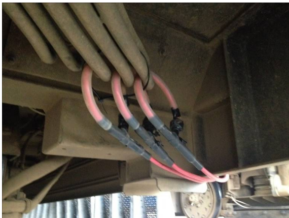
Rys.2. Miejsce wpięcia cewek Rogowskiego podczas pomiarów diagnostycznych silników w układach napędowych wagonów tramwajowych
