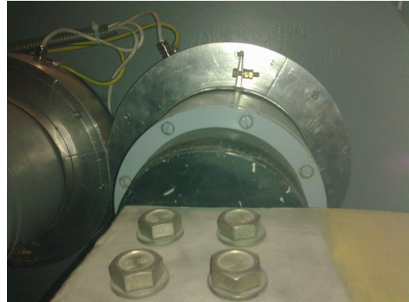
Rys. 4. Cewki Rogowskiego zainstalowane na przepustach generatora 40 MW, 6.6 kV
