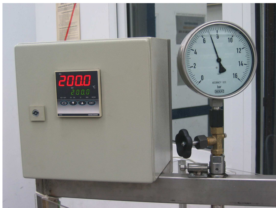
Fot. 6. Widok sterownika z manometrem
