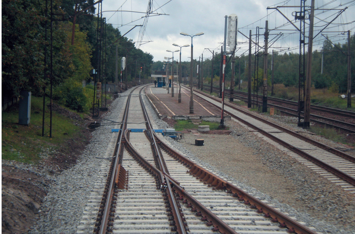
Fot. 1. Przystanek i posterunek odgałęźny Bydgoszcz Leśna na zrewitalizowanej linii nr 18 (14.09.2013 r.)
