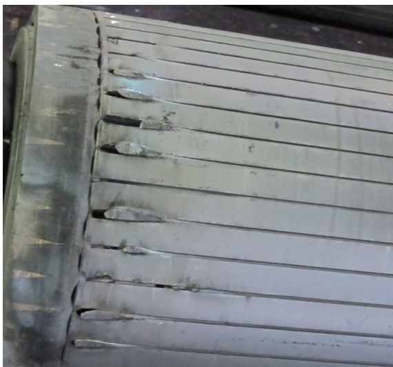
Rys. 4. Uszkodzona klatka rozruchowa
