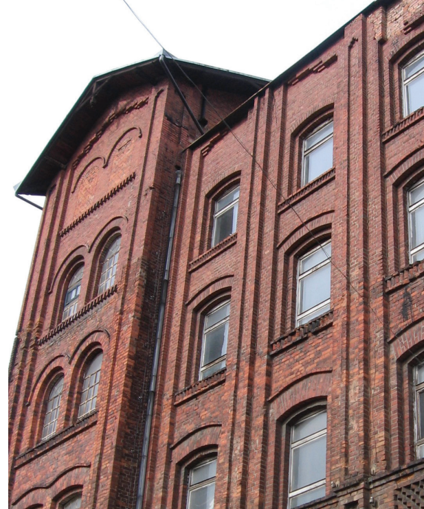
Fot. 2. Lizeny, gzymsy, opaski na ceglanej elewacji
