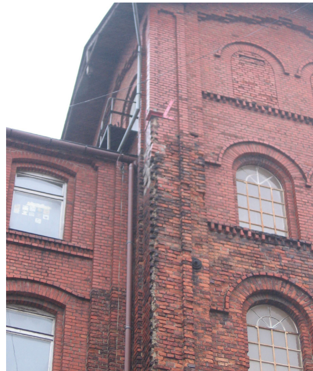
Fot. 4. Skorodowany narożnik wieży.
