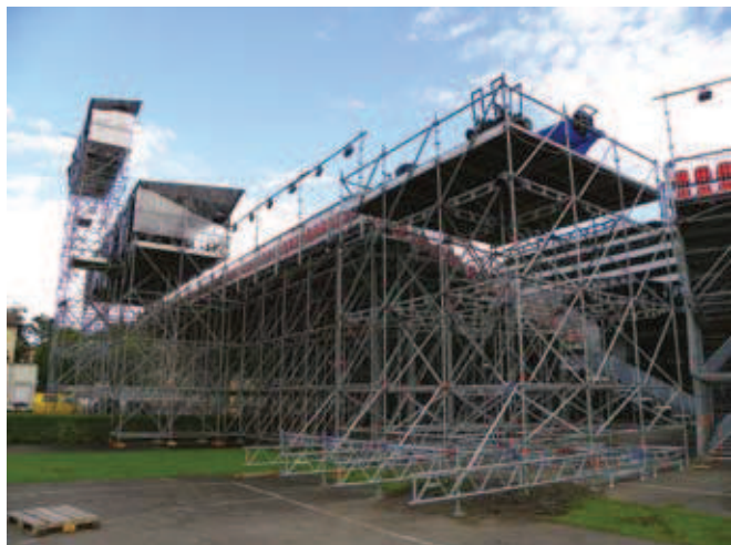
Rys. 4. Widok na wieże reżyserski oświetlenia i dźwięku, kotwione do tyłu trybun amfiteatralnych
